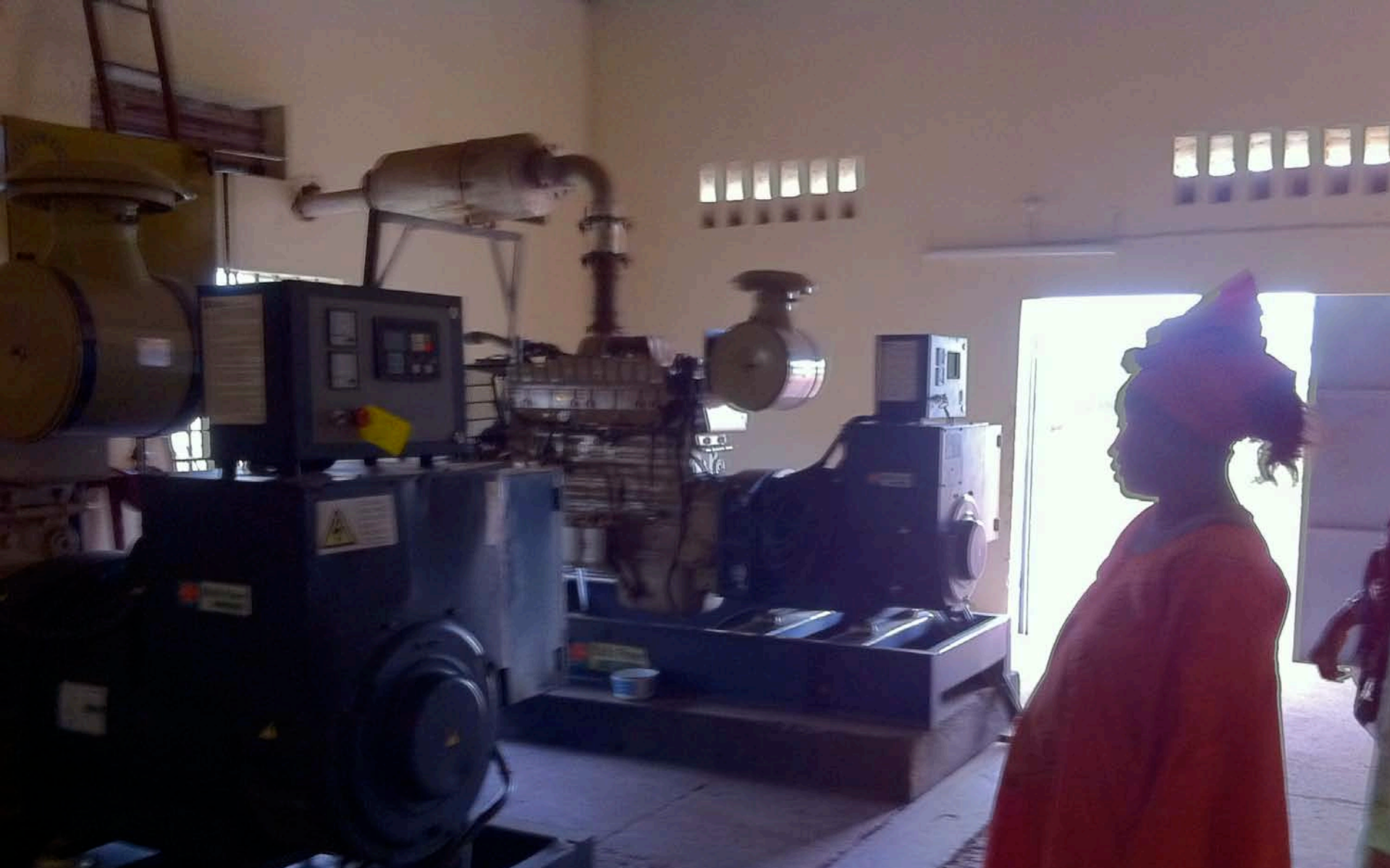
Centrale électrique 2x300 kVA gérée par une femme à Bla, MALI
